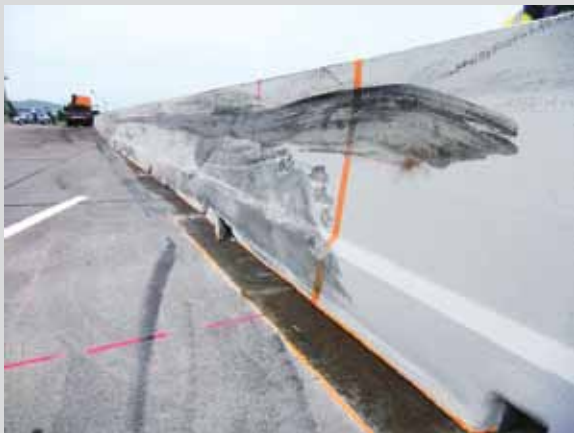
Fig. 9: léger déplacement d'un mur de protection en béton ayant une capacité de retenue élevée
