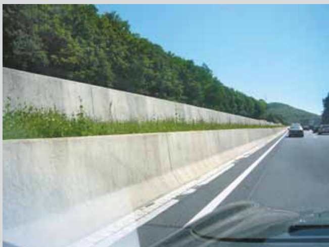
Fig. 2. Dispositif de sécurité le long d'un tronçon de route
