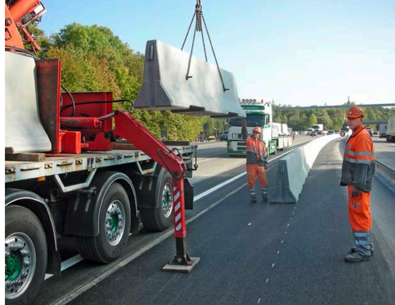
Die Betonelemente werden gesetzt, während im Hintergrund der Verkehr über die Stadttangente Bern rollt. (Bild: Sacac)
